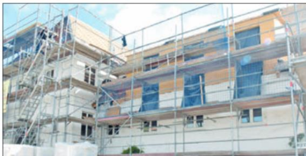
Das gesamte Gebäude ist eingerüstet. Es gibt kaum einen Bereich, der nicht vom Umbau betroffen ist.
